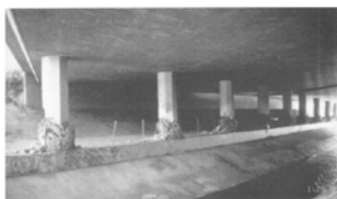
شکل ۱ شکست فشاری ستون‌های پل بال کریک در زلزله نورث ریج کوبه
