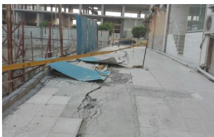
شکل ۱ گسیختگی در پی‌ها و ترک‌های کششی به دلیل خاک‌برداری و هوازگی خاک مارن در جزیره قشم
