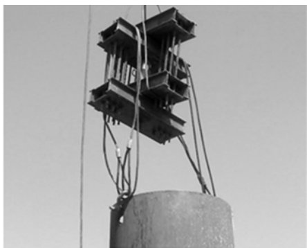
شکل ۳ اعمال نیروی کششی به شمع‌ها
